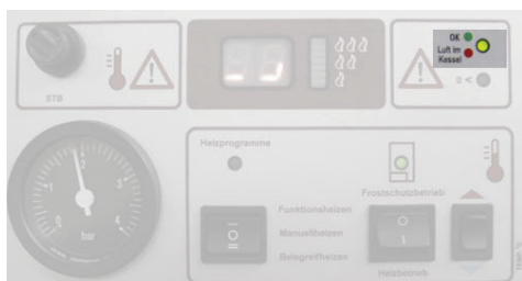
Bild: Bedienfeld LED-Kontroll-Anzeige „Kesselentlüftung“
